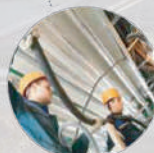
Instalaciones de Cables
