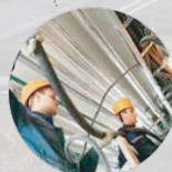
Instalaciones de Cables
